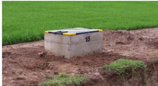
Fotografía 2-19 Cajas de empalme de MT concreto
