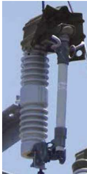
Fotografía 2-20 Fundas aislantes tipo referencia Tyco BCAC-G-CUTOUT-FUSE CUTOUT COVER
