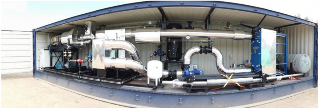
Figura 2-132 Unidad de flujo cerrado- Proceso de Optimización del potencial calórico proveniente del agua de producción
